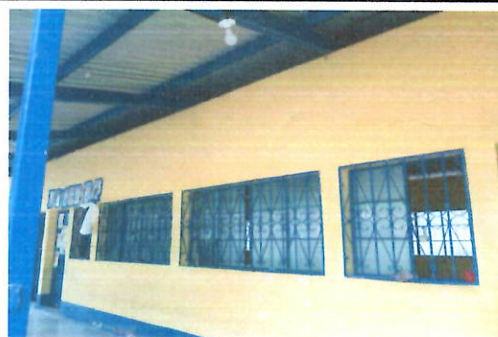
Foto 10: ventanas: sustrución de ventanas; sistema de apertura: corredizas, perfiles color blanco estandar, material del marco: PVC, material de la ventana: vidrio, sellado perimetral. Aula 1
